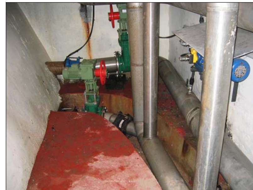
VISTES DE L'INTERIOR DE LA CAMBRA DE CLAUS
