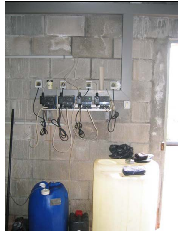
INJECCIÓ DE CLOR I FLUOCULANT
