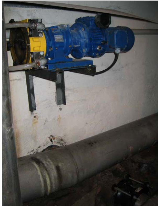
BOMBA INJECCIÓ DE CLOR
